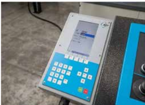
Seitlich der Bedienkonsole der Maschine montierte Steuerung
